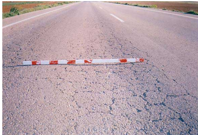
Figura 2.2.1. Deterioro de la carretera por deformación permanente de la explanada. Fuente: Firmes Ecológicos SOLTEC.
