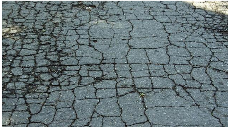
Figura 2.4.1. Deterioro de la carretera por fisuración por fatiga de la MBC. Fuente: Asociación Española de la Carretera. (AEC)
